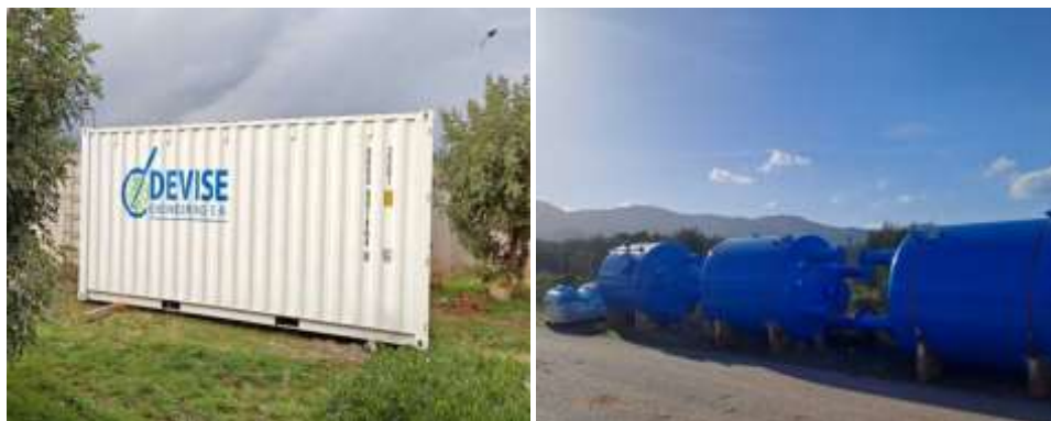
ΕΕΛ Μαλίων: (α) Προσθήκη νέου συστήματος απολύμανσης της τριτοβάθμιας εκροής με χρήση UV, (β) Μονάδα Φίλτρασης ΕΕΛ Μαλίων
