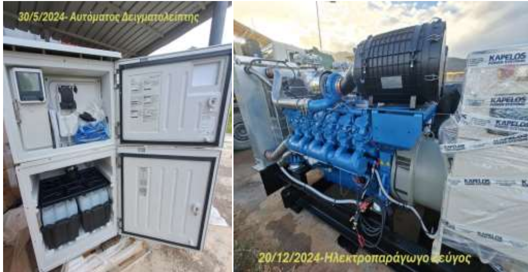
ΕΕΛ Μαλίων: (α) Αυτόματος Δειγματολήπτης αντιπροσωπευτικού Δείγματος ΕΕΛ Μαλίων, (β) Ηλεκτροπαραγωγό Ζεύγος ΕΕΛ Μαλίων
