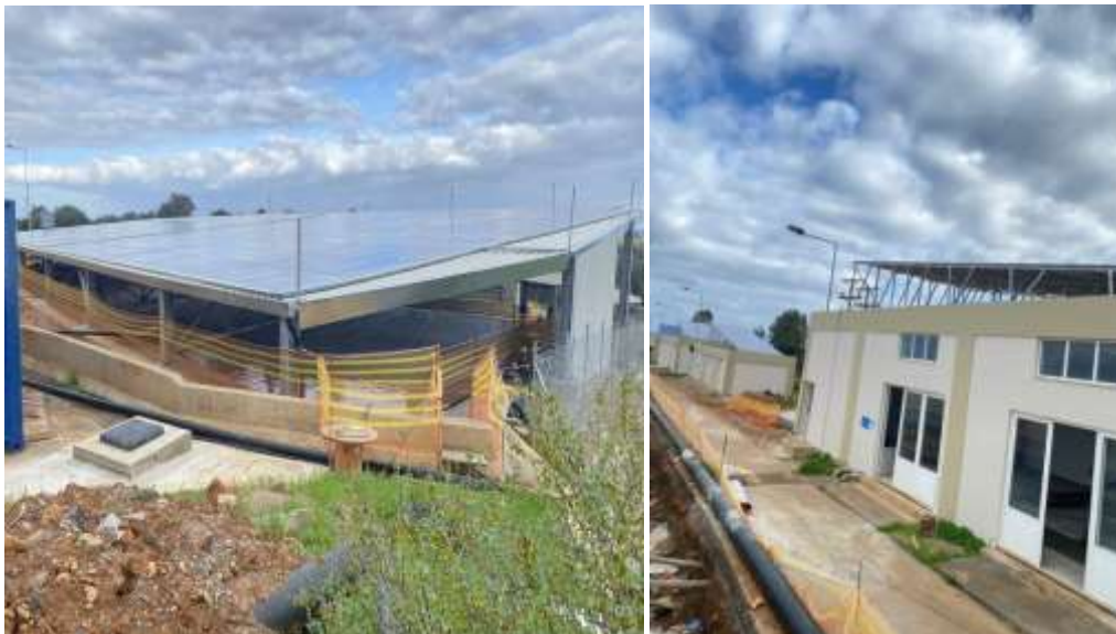
Προμήθεια, εγκατάσταση και θέση σε λειτουργία ενός (1) Φωτοβολταϊκού (Φ/Β) σταθμού. Φωτοβολταϊκά πάνελ: (α) πάνω στη δεξαμενή επεξεργασμένων υδάτων της ΕΕΛ Μαλίων, (β) στα κτήρια εξυπηρέτησης της ΕΕΛ Μαλίων
