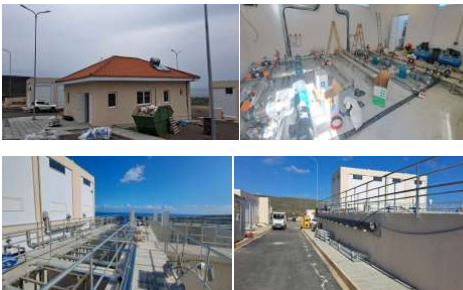
Γενικές φωτογραφίες της ΕΕΛ Καρτερού και Κοκκίνη Χάνι – Βαθειανού Κάμπου
