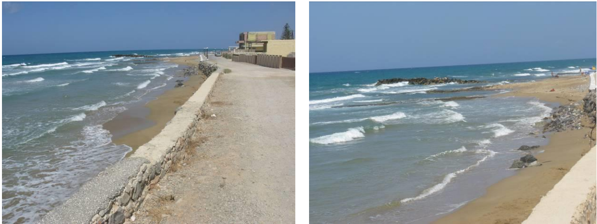
Εικ. 53: Τσιμεντένιο κρηπίδωμα "προστασίας" του παραλιακού δρόμου. (Φωτογραφίες Αναγνώστου 01-Αυγ. 2012).
