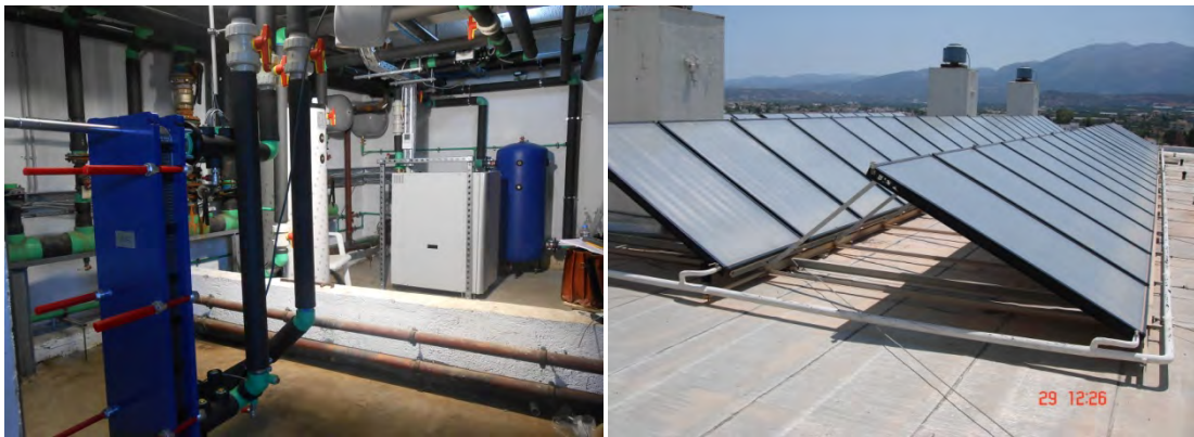
Εικόνα 10: Συστήματα εξοικονόμησης ενέργειας στο ξενοδοχείο Sirens Beach and Village Hotel
