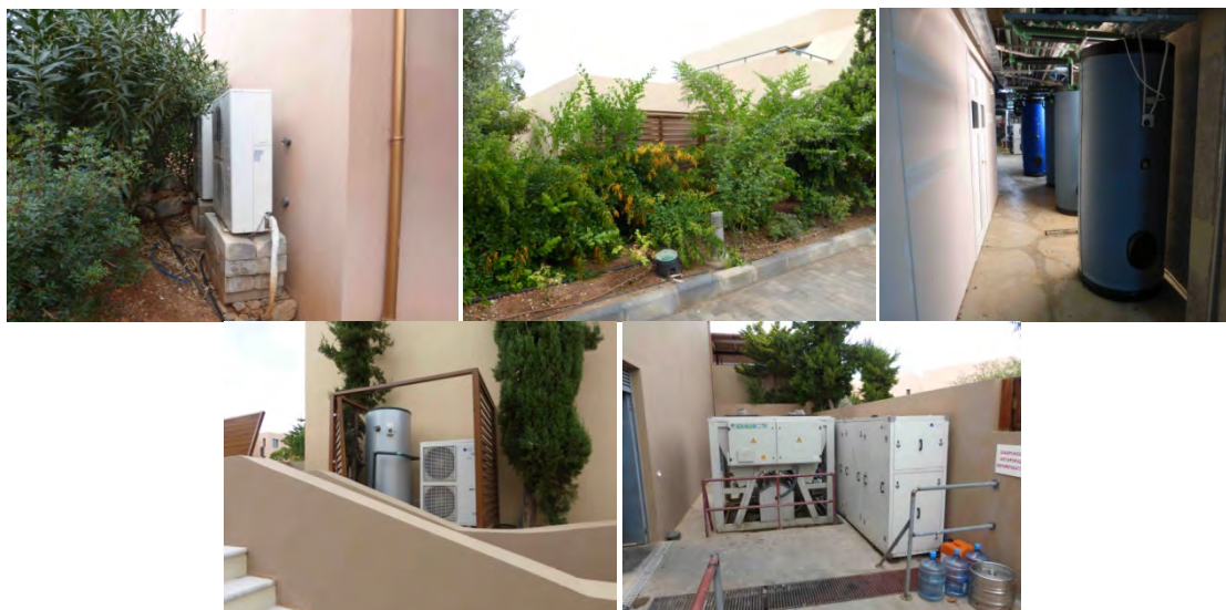
Εικόνα9: Εγκατάσταση αντλιών θερμότητας και θερμοδοχείων με εναλλάκτη σε κεντρικό μηχανοστάσιο του ξενοδοχείου Village Heights Golf Resort. Εγκατάσταση αντλιών θερμότητας σε τμήματα τις εγκατάστασης (τμηματοποίηση δικτύου). Μετατροπή ψύκτη σε αντλία θερμότητας ψύξης-θέρμανση-ανάκτησης θερμότητας
