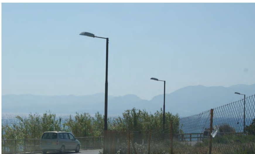
Εικόνα 2: Φωτιστικά LED Αστικού – Οδικού Φωτισμού Δήμου Χερσονήσου με χρηματοδότηση από το «Πράσινο Ταμείο».
